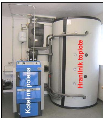
Slika 43; Kotel na polena s hranilnikom toplote, ki toploto iz kotla prevzema, ko jo grelna telesa ne porabljajo v celoti (Vir: www.baudochselbst.com )
